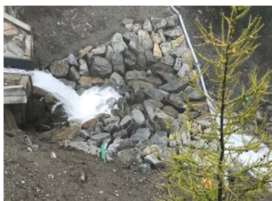
Barrière pré-remplie à l'aide de gros blocs, vue d'en haut (Image: [I]).
